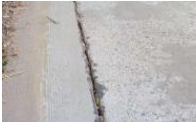
Gambar 2.7 Retak Sambungan Pelebaran Jalan
