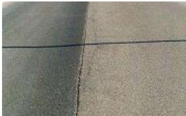
Gambar 2.6 Retak Sambungan Jalan
