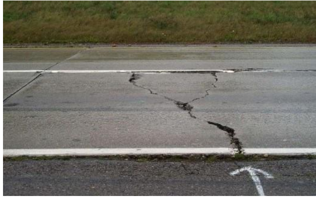
Gambar 2.5 Retak Sambungan Bahu
