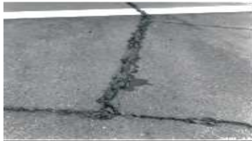
Gambar 2. 9. Retak reflektif sambungan ( join reflective cracks )
