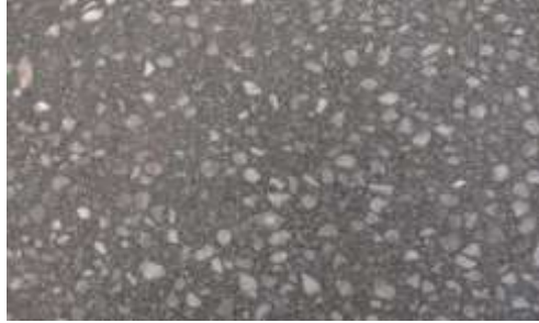
Gambar 2. 15. Kondisi agregat licin pada jalan aspal
