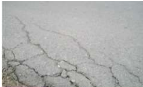
Gambar 2. 19. Kondisi retak pinggir ( edge cracking )
