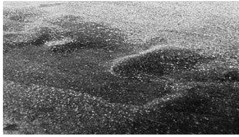
Gambar 2. 4. Jenis kerusakan sungkur ( shoving ) pada jalan Sumber : Dinas Pekerjaan Umum,2023
