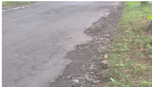
Gambar 2. 20. Kondisi penurunan jalur/bahu jalan
