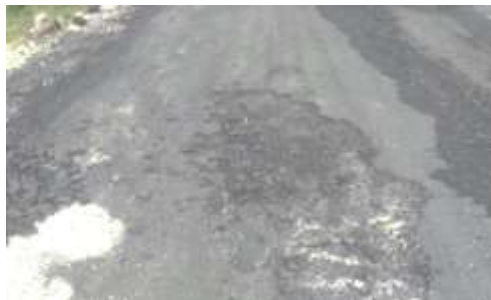
Gambar 2. 16. Kondisi terkelupas pada aspal
