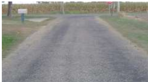
Gambar 2. 14. Kegemukan pada aspal jalan
