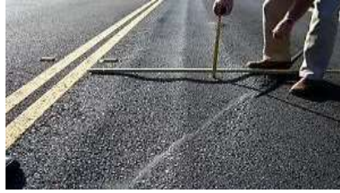
Gambar 2. 2. Jenis kerusakan alur ( Ruttin ) pada jalan
