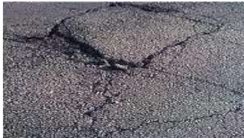
Gambar 2. 5. Jenis kerusakan mengembang ( swell ) pada jalan Sumber : Dinas Pekerjaan Umum,2023
