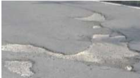
Gambar 2. 17. Kondisi kerusakan stripping
