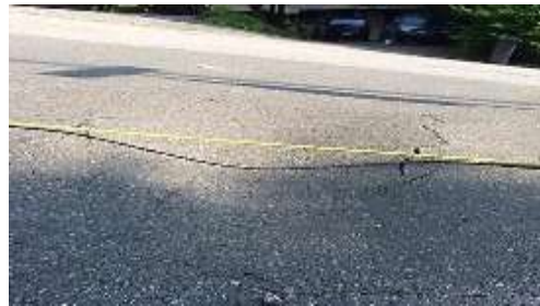
Gambar 2. 3. Jenis kerusakan ambles ( depression ) pada jalan
