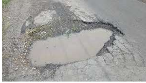
Gambar 2. 18. Jenis kerusakan lubang pada jalan aspal
